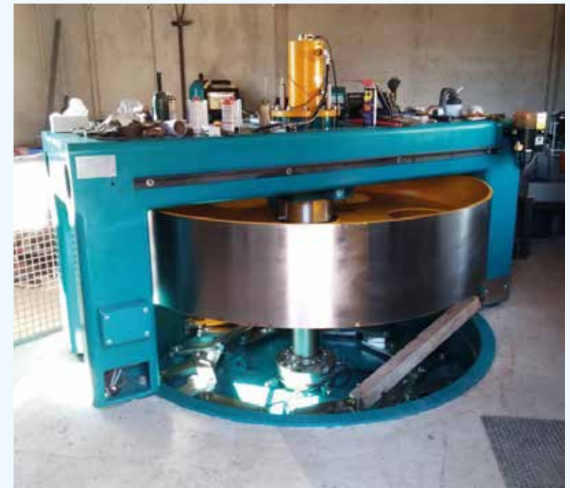
Neue Turbine mit 75 KW Leistung
