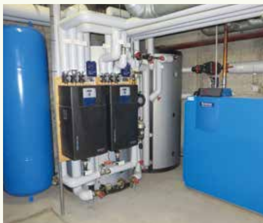
Trinkwasserversorgung, Speicher und Kessel
